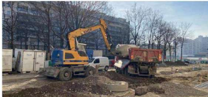
Les travaux d'implantation des poteaux de ligne aérienne de contact rue Billon. Photo Sofiane Sefricun
